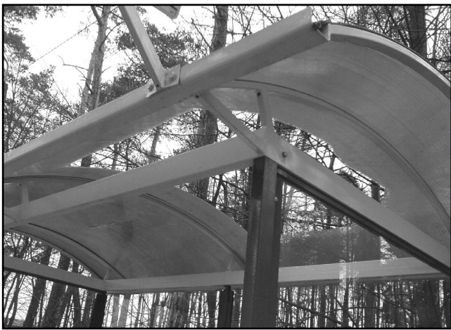
Zniszczona wiata na przystanku w Bojszowach Nowych
